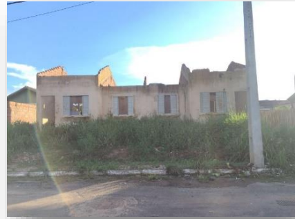
Figura 3. Unidades habitacionais abandonadas no conjunto Cabreúva.
