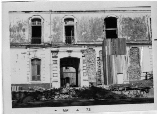
Figura 26: exterior da Capela durante o processo de restauração, fotografias tomadas em máquina polaróide. Fonte: Acervo La Rocque Soares doado ao LAMEMO/UFGPA,
