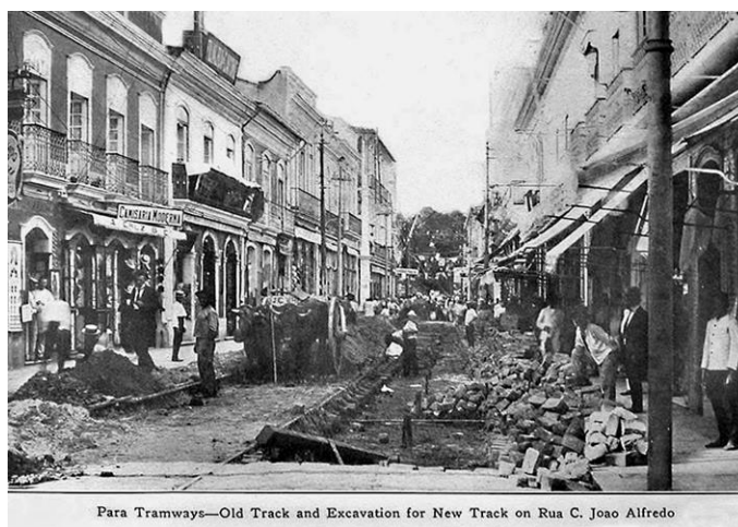
Figura 05: Construção da linha férrea na Rua João Alfredo, centro urbano de Belém, em 1907.
