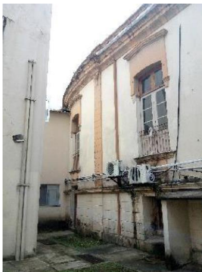
Figura 43 - Fachada posterior, onde se vê um anexo no bloco, assim como a inserção de tubulações e condensadores de ar.
