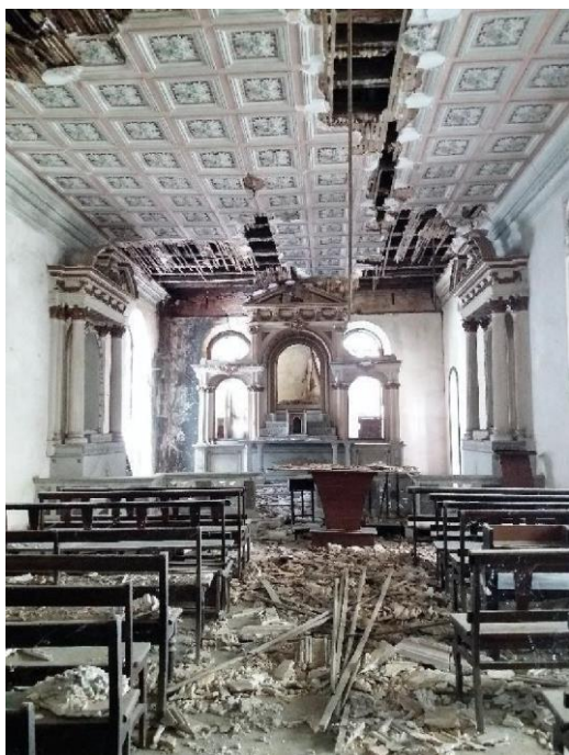
Figura 51 - Estado atual da Capela em seu interior.
